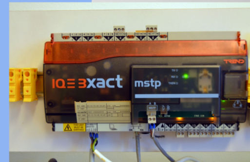
Laboratorium Automatyki Budynków
